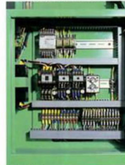
▲ 主電氣箱 Main electricity box
